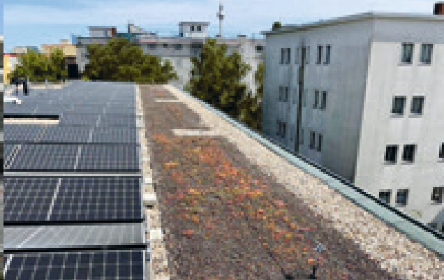
WA 800 Ernst-Reuter Siedlung - Dach mit Photovoltaikanlage
