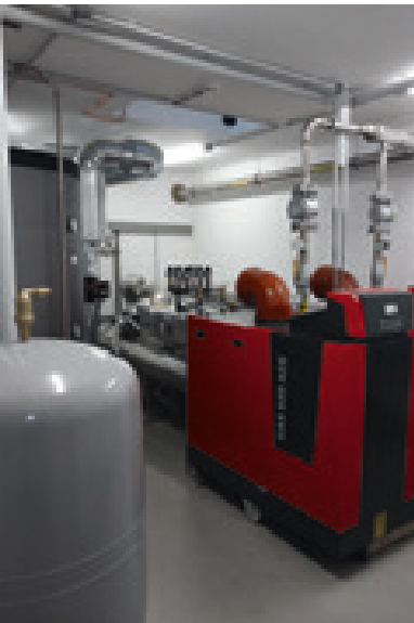
WA 607 Niederschönhausen - Heizzentrale
